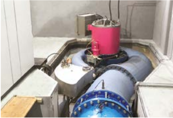
Kraftwerk Moulin d'Arignac (Calvière) mit einer DIVE-HAX-Turbine.
