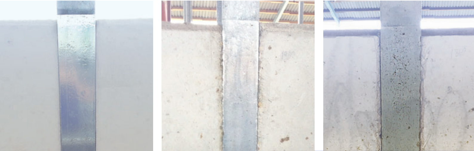
Links: Nach der Aufbringung; Mitte: Kontrolle nach ca. 8 Monaten; Rechts: Kontrolle nach ca. 3 Jahren
