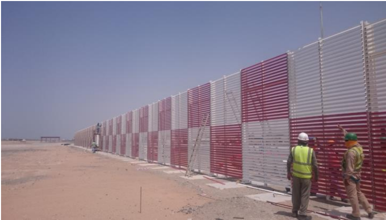
Clôtures de protection contre le vent à l'aéroport de Mascate/Oman (Source : RSB, Dortmund) (Proximité de l'océan/désert, revêtement à haute protection contre les intempéries)
