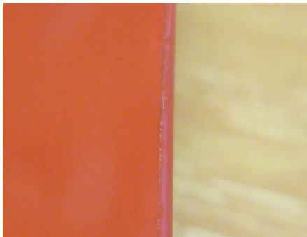
Scharfe Kante mit ungenügender Abdeckung
