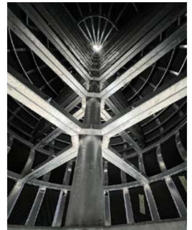
Innenansicht des Ballons mit den zur Probe aufgebrauchten Stoffbahnen - das Innengerüst ist bereits verzinkt. (© C. Heider Metallbau GbR)
